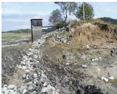
Fig. 7 Metelský rybník (2002), failure by overtopping [photo: Říha]
